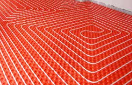
Figuur 121. Afgiftesysteem: vloerverwarming
